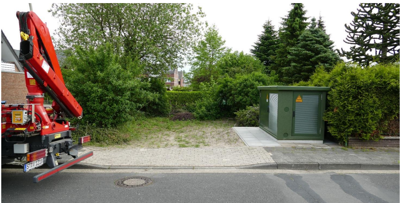
Abbildung 3: Neue 10-kV-Trafoeinheit auf dem Flurstück 14/1
